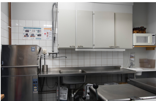
Disk- och arbetsytor i anläggningsköket.
